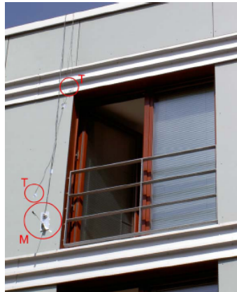
Abb. A5.1.2-25: Messstation auf der Fassade, T= Temperatursensor, M = Messstation
