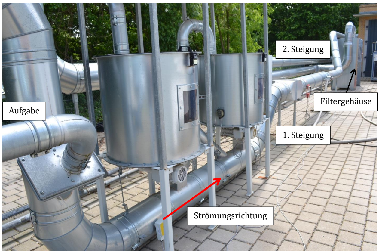
Bild 35: pneumatische Förderanlage auf dem Firmengelände der Fagus-GreCon Greten GmbH & Co. KG
