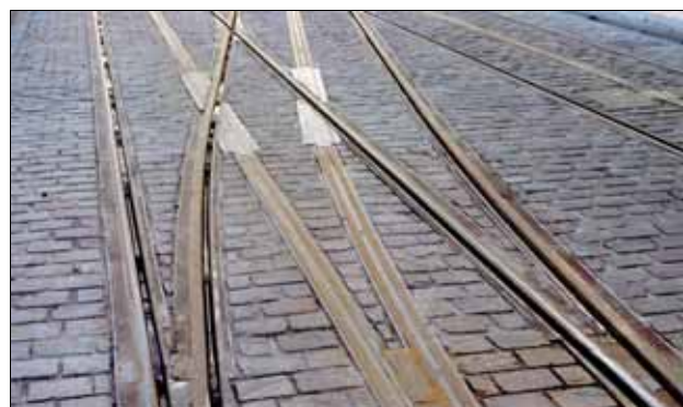
Abb. 113, 114: Details des Unterleitungssystems von Bordeaux – Systemwechselstelle und Weichenbereich
