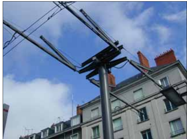
Abb. 111: Detail der Oberleitung in Orléans
