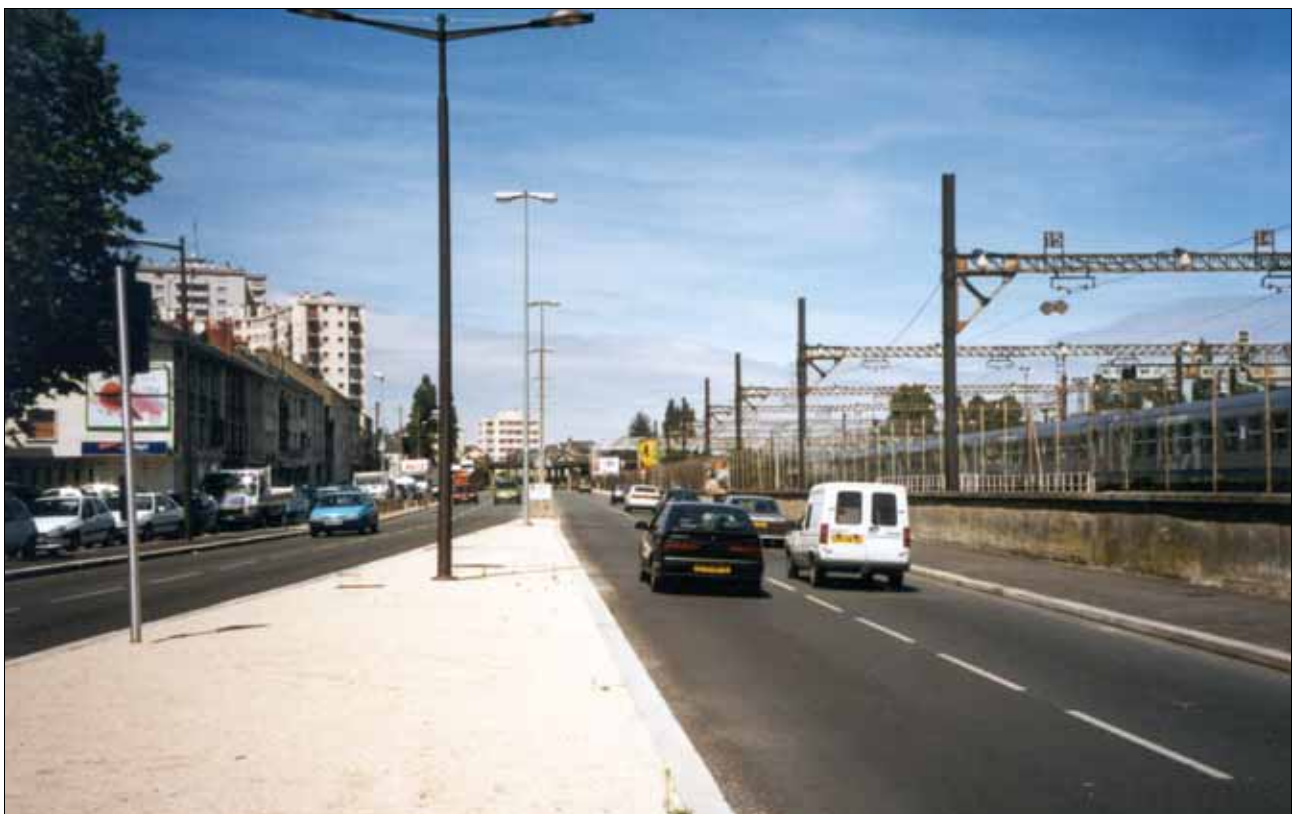
Abb. 45, 46: Der Bau einer Straßenbahnstrecke bietet enorme gestalterische Chancen und Möglichkeiten – Beispiel der Umgestaltung eines Straßenraumes in Orléans, Avenue de Paris
