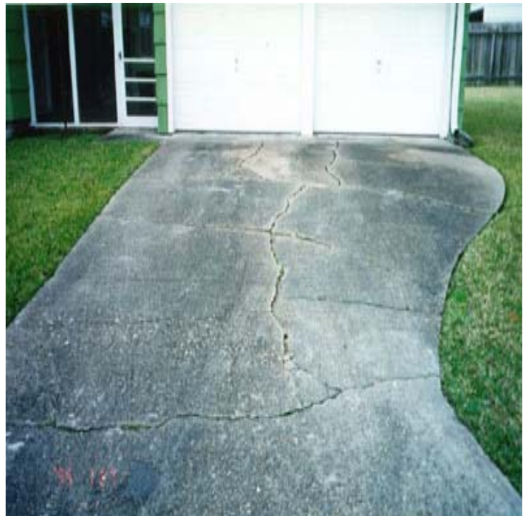
Durch Bodenquellung beschädigte Einfahrtstraße
