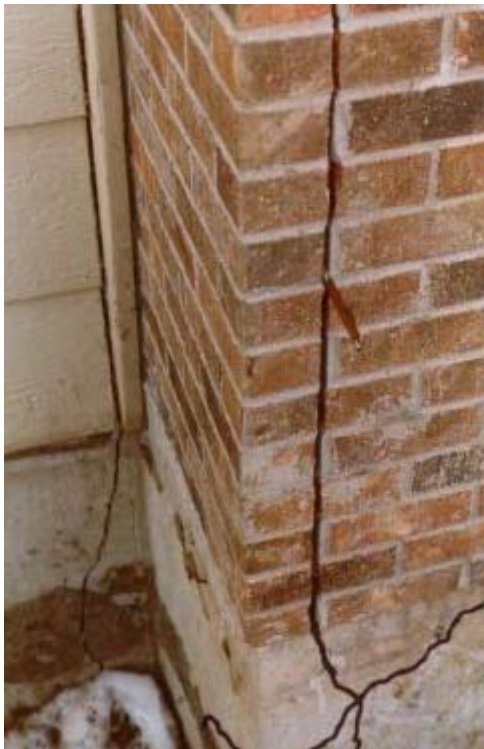
Risse in den Außenwänden, resultierend aus einer Bodenquellung
