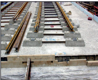
Bild E.20: Schwingungsgedämpftes Straßenbahngleis mit Betontragplatte und Zweiblockschwellen. Die Schwellenfächer werden anschließend mit Magerbeton ausgefüllt.
