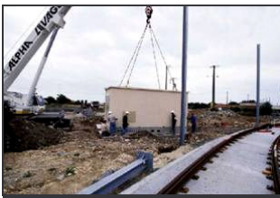
Bild 136: Kostenersparnis durch vorinstallierte Unterwerke (ALSTOM)
