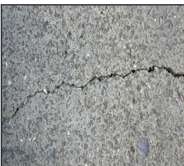
Bild E.14: Mikrorisse müssen bei einem halbstarren Belag in Kauf genommen werden.
