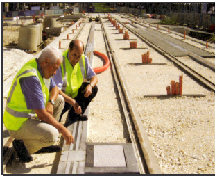
Bild C.7: Einer der Stromeinspeisungspunkte, die in Bordeaux alle 22 m eingebaut werden. Zu beiden Seiten des Stromeinspeisungspunktes sind zunächst die Isolierabschnitte zu erkennen (jeweils 1,5 m lang), daran schließt dann ein 8 m stromführender Abschnitt an. (LA VIE DU RAIL)
