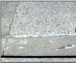
Bild E.2: Halbstarre Deckschicht. Deutlich sind Zementschleier des eingerüttelten Zement-Kunststoff-Bindemittels auf dem Randbord zu erkennen.
