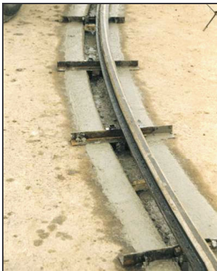
Bild E.5: Nachträglich eingebauter Betontrög. Die Monoschiene liegt zum Einbau bereit. (LOHR INDUSTRIE)
