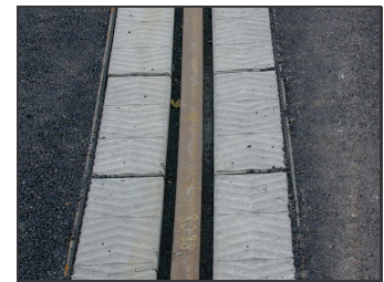
Bild B.20: Die Asphaltbefestigung wird bis an den zunächst noch offenen Stahlrog der Monoschiene geführt. Da die Monoschiene austauschbar befestigt wird, kommen abnehmbare Formsteine zur Überdeckung der Schienenbefestigung zum Einsatz.
