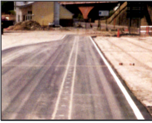
Bild B.28: Gut zu erkennen sind die Frässpuren der eingelassenen Leitdrähte beim System ELTRAC. (CÉGÉLEC)
