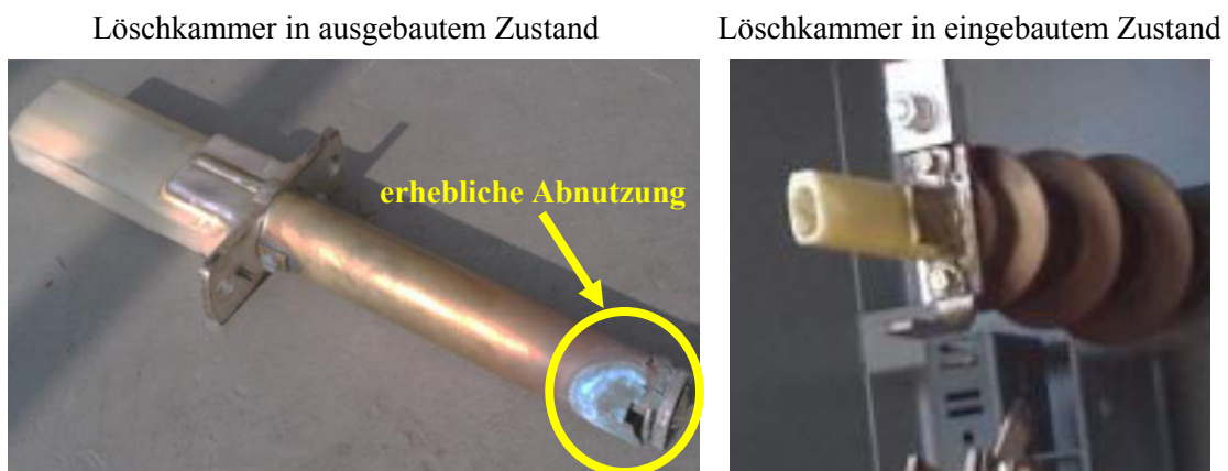
Abbildung 60: Fehlerbild einer Löschkammer [55]
