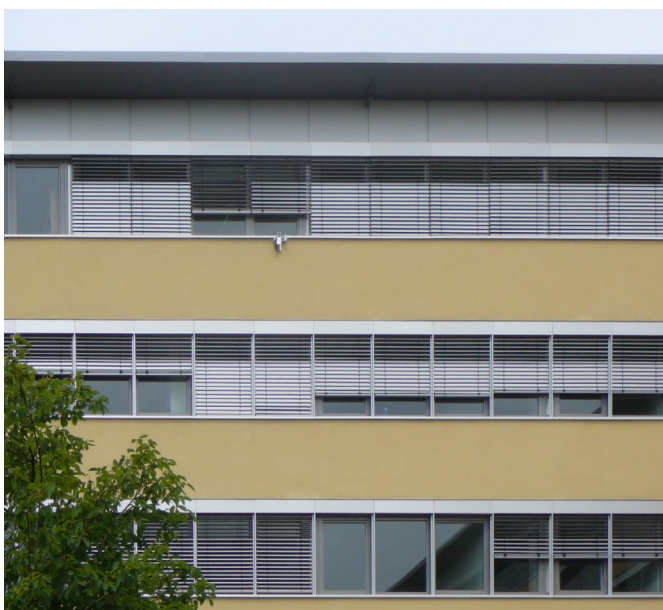
Abb. 74: Der untersuchte Gebäudeteil des SIC ist mit einem gelb gestrichenen Wärmedämmverbundsystem versehen. Die Außenluft wird im Verschattungsbereich der Jalousiekästen angesaugt.
