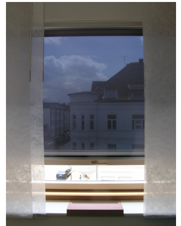
Abb. 51: Zuluftöffnung in der Fensterbank eines Praxisraums im 3. OG. Der Brüstungskasten kann mit PCM-Platten zur Kühlung der Zuluft ausgerüstet werden.
