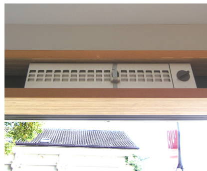
Abb. 93: Klein-Logger an einem schalldämmenden Zuluftelement in der Apotheke im EG.
