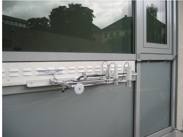
Abb. 227: Fassendensensor am unteren Lüftungselement.
