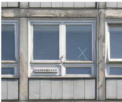
Abb. 86: Aktives Lüftungselement in einem Gruppenbüro auf der SW-Seite.
