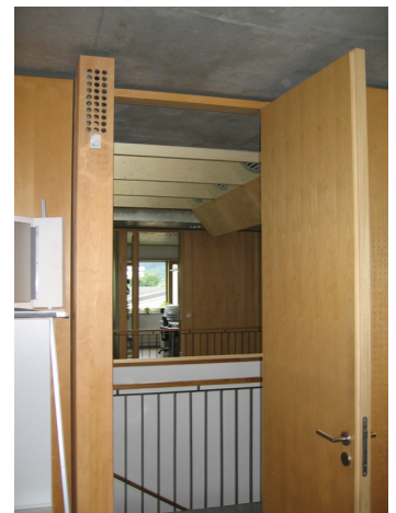
Abb. 31: Überströmöffnung neben einer Bürotür zum Atrium. Aus dem Atrium wird die Abluft im Deckenbereich zentral abgesaugt.
