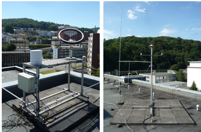
Abb. 218: Wetterstation am Campus Haspel auf dem Dach eines viergeschossigen Universitätsgebäudes. Links: Diffusstrahlungs-, Lufttemperatur-, Luftfeuchte- und Regensensor; rechts: Globalstrahlungs-, Windgeschwindigkeits- und –richtungs-Sensor.
