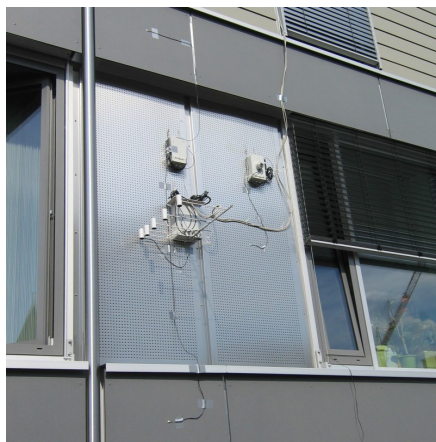
Abb. 90: Messtechnik an der Süd-Fassade.
