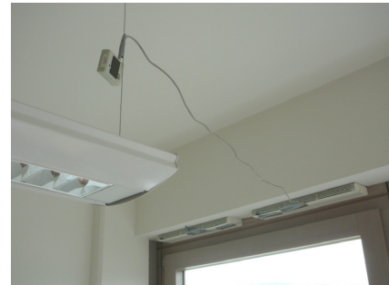
Abb. 102: Klein-Logger mit externem Temperaturmesskopf am Auslass eines Lüftungselementes an der Süd-Ost-Fassade.
