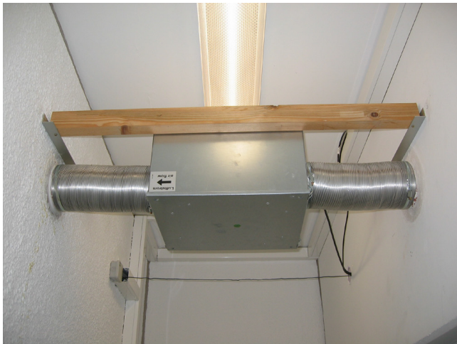
Abb. 212: Im Vorraum der BTGA-Box installierte Abluftanlage.
