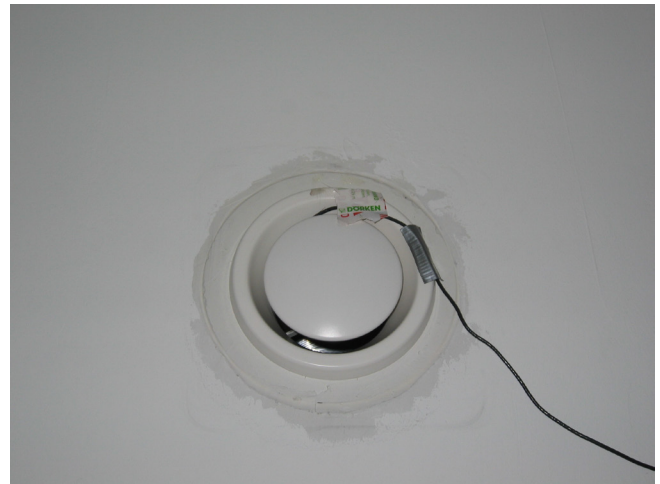
Abb. 213: Tellerventil im Messraum mit Ablufttemperatur-Sensor.
