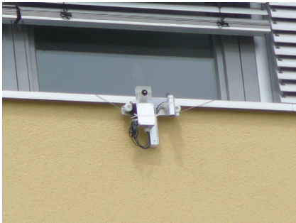
Abb. 100: Modul zur Messung von Gesamtstrahlung und Lufttemperatur an der Fassade.
