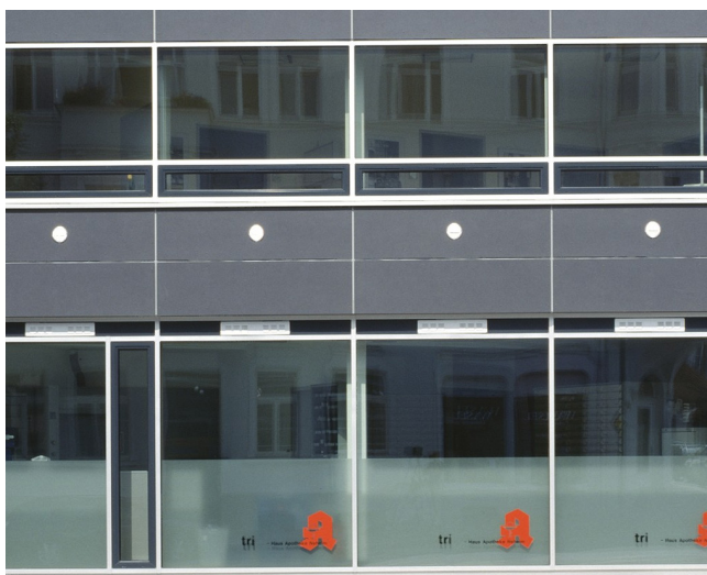
Abb. 53: Der Fassadenausschnitt zeigt die runden Zuluftelemente im Brüstungsbereich des 1. OG und die schalldämmten Elemente vom Typ Aeromat 150 oberhalb der Fenster im EG.
