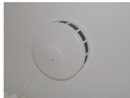
Abb. 120: Raumseitige Zuluftöffnung, abgedeckt mit einem Kunststofftopf.
