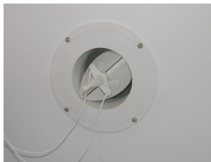
Abb. 119: Manuell verschließbare Fassadendurchführung.
