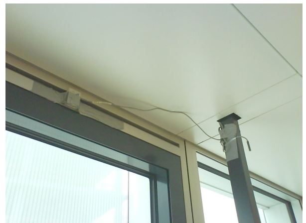
Abb. 99: Kleinlogger an der Zuluftöffnung mit externem Messkopf zur Erfassung der Raumlufttemperaturen.
