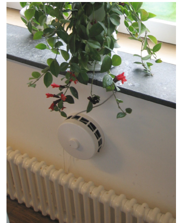
Abb. 30: Zuluftelement im Brüstungsbereich eines Büros.
