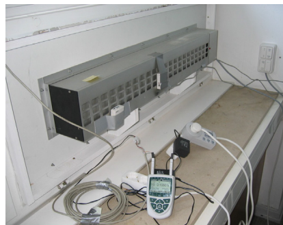
Abb. 87: Messtechnik am Lüftungsgerät.
