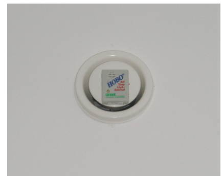
Abb. 94: Klein-Logger am Abluft-Tellerventil in einem Behandlungsraum.
