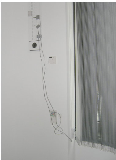
Abb. 89: Temperatursensoren an einem Zuluftelement auf der Süd-Seite.
