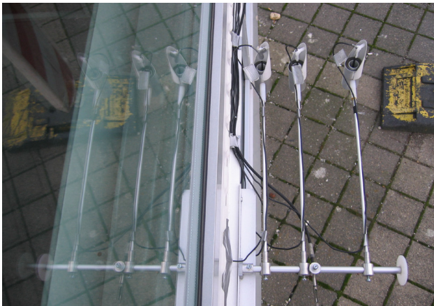
Abb. 217: Sensor an der Süd-Fassade der BTGA-Box zur Messung von Auftriebsströmungen und eines Temperaturprofils. Zum Schutz vor Strahlungseinflüssen sind die Temperatursensoren mit Doppelhülsen ummantelt.
