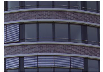
Abb. 79: Detailansicht der Fassade: Das Edelstahlband oberhalb der Fenster beherbergt die Jalousien, sein Pendant unterhalb der Fenster die Außenluftansaugung. (Foto: Imtech)
