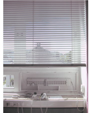
Abb. 37: Zu Testzwecken in ein Gruppen-Büro eingebautes Lüftungsgerät.
