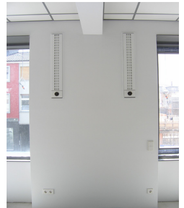
Abb. 44: Schalldämmende Zuluft-elemente vom Typ Aeromat 150 in der Süd-West-Fassade im 1. OG.
