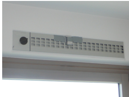
Abb. 101: Kleinlogger an einem schallgedämmten Lüftungselement an der Nord-West-Fassade.
