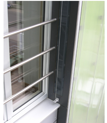
Abb. 58: Außenluftansaugung in einer west-orientierten Fensterlaibung. Die Jalousie schützt auch das Lüftungsgitter vor direkter Sonneneinstrahlung.
