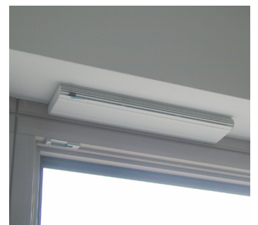
Abb. 73: Einfaches Lüftungselement ohne Schallschutz-Funktion in einem zum Innenhof orientierten Büro.
