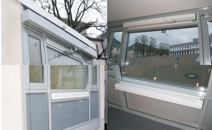
Abb. 210: Einbausituation der Lüftungselemente im Messraum: Die fassadenseitige Außenluftansaugung erfolgt in der Fassadenebene; raumseitig begünstigt das Auskragen der Zuluftelemente den Wärmeaustausch mit dem Raum.
