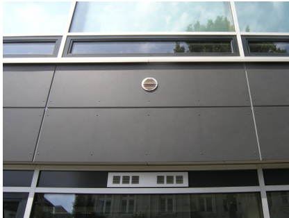
Abb. 153: Fassadenseitige Luftansaugung der Apotheke im Erdgeschoss und der Obergeschosse.
