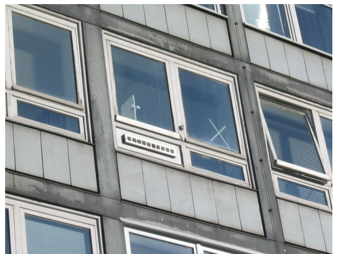
Abb. 40: Fassadenausschnitt mit Lüftungsgerät.
