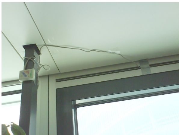
Abb. 98: Kleinlogger zur Messung der Raumtemperatur mit externem Messkopf an der Zuluftöffnung.
