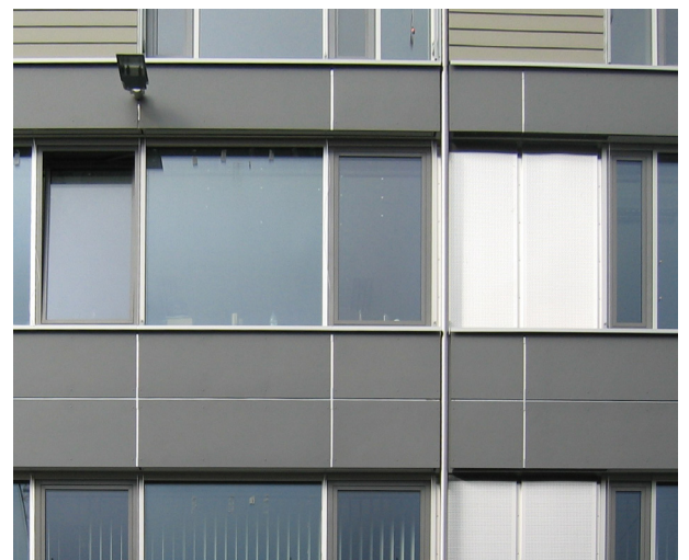
Abb. 47: Fassadenausschnitt: Die Zuluftelemente sind hinter Edelstahl-Lochblechen zwischen den Fenstern eingebaut.
