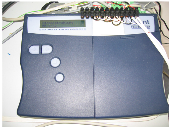
Abb. 220: Daten-Logger und Steuereinheit vom Typ Squirrel 2020 zur Erfassung der Messdaten und Steuerung der Anlagen im Messraum „BTGA-Box“.
