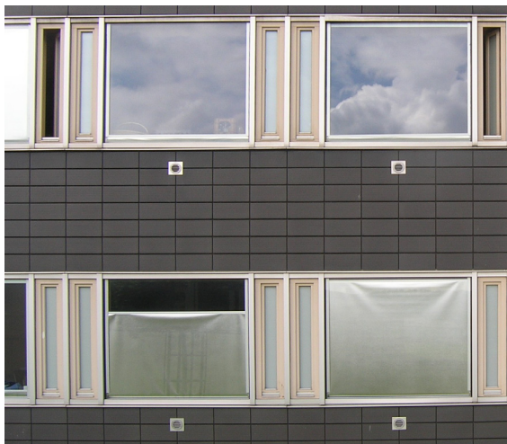
Abb. 32: Fassadenausschnitt: Gut erkennbar sind die runden Edelstahl Ansauggitter, der zwischen den Scheiben liegende Sonnenschutz und die schmalen Drehfenster.
