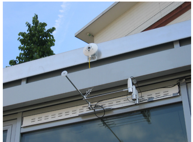
Abb. 225: Pyranometer und Profil-Sensor bei der Messung am oberen Lüftungselement.
