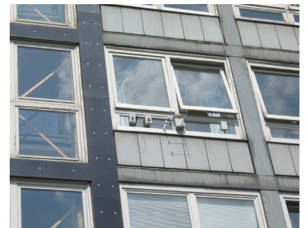
Abb. 88: Strahlungs- und Temperaturprofil-Sensor an der SW-Fassade.
