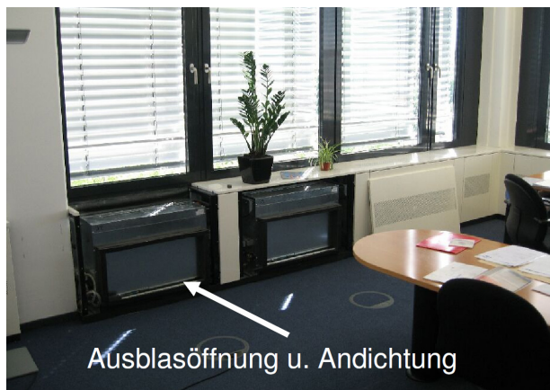
Abb. 81: Einbausituation der Brüstungsgeräte in einem der untersuchten Räume. (Bild: Imtech)
