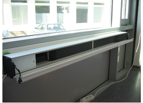
Abb. 211: Geöffnetes Lüftungselement: Die Luft strömt links in einen vorgelagerten, zum Raum hin ungedämmten Blechkanal ein und verlässt diesen nach einer Wegstrecke von ca. 1,50 m am Auslass auf der rechten Seite.
