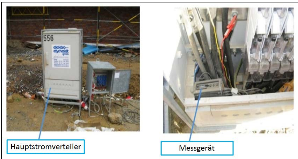
Abb. 4.52: Messgerät im Hauptstromverteiler der Werkhalle 224
