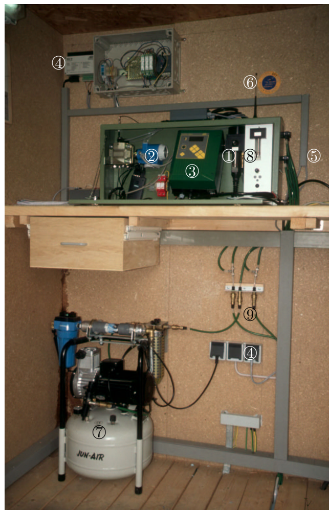
Bild 4.3: Technische Einrichtung der Differenzdruckanlage
