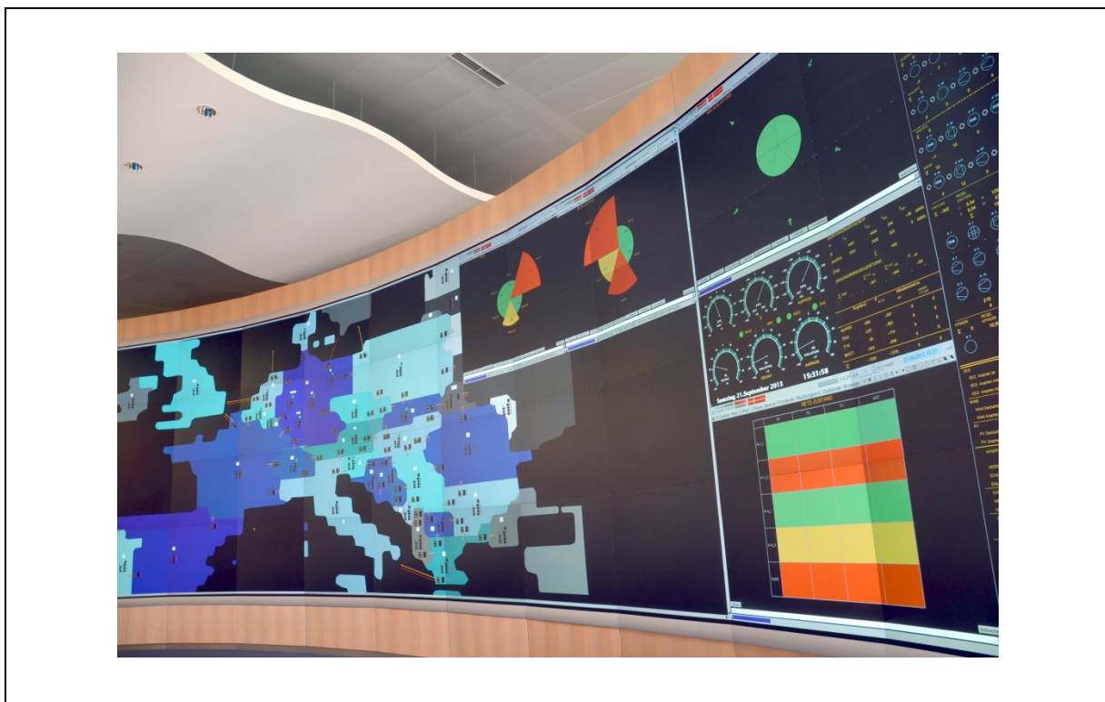
Bild 6.21: Großbildanzeige mit Systemzustandsanzeige in der Netzleitstelle
