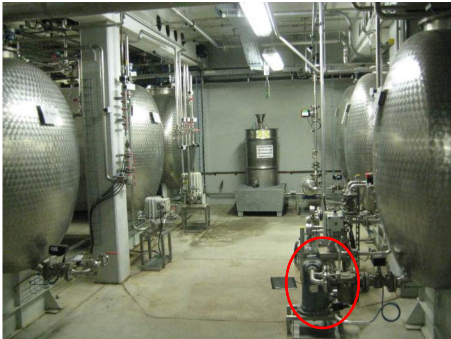
Bild 17: Tanklager (Flammendurchschlagsicherungen im Vordergrund) [49]
