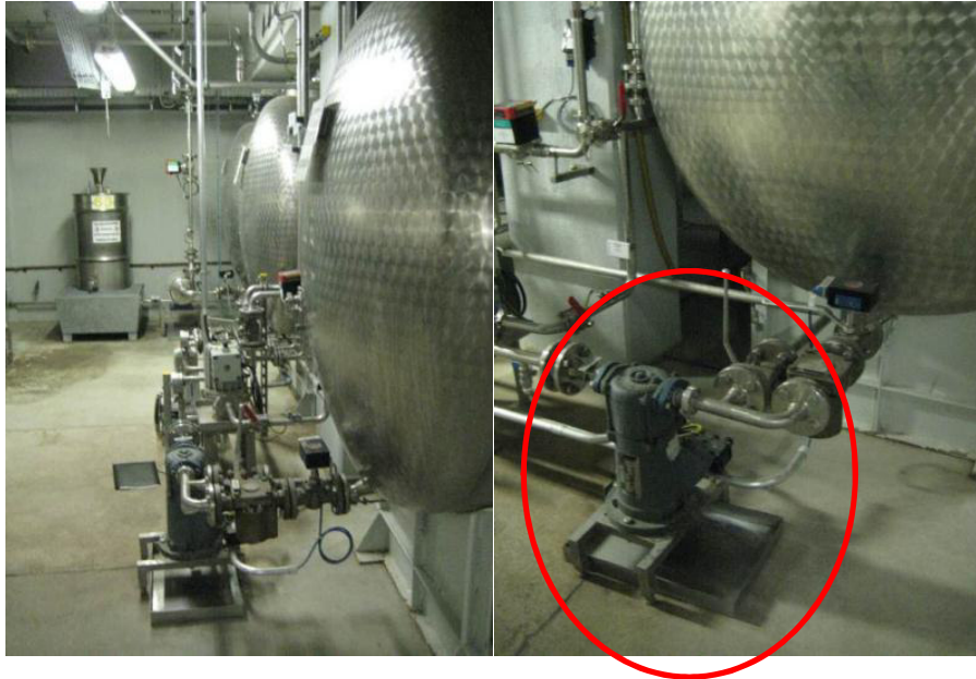
Bild 18: Flammendurchschlagsicherungen und Installationen [49]
