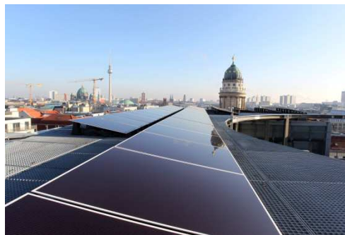
Abbildung 1: Solarmodule auf einem Hausdach (Quelle: BSW-Solar/Upmann)
