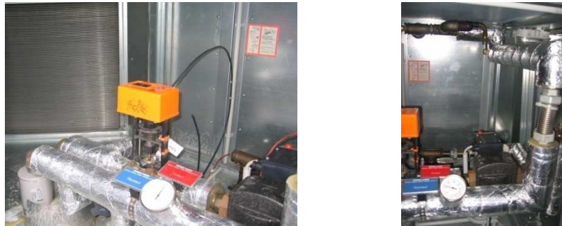
Bild 3.18) Blick in den Abluftkanal einer Lüftungsanlage. Im linken Bild sind hinten links die Platten des Wärmeübertragers der Wärmerückgewinnung zu erkennen, im Vordergrund und auf dem rechten Bild ein Teil der Rohrleitungen und Anschlüsse des Heizregisters (das sich direkt daneben im Zuluftkanal befindet).
