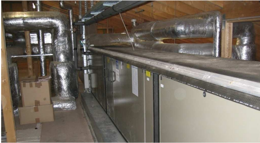
Bild 3.30) Lüftungsgerät des PH- Wohnheims auf dem Umweltcampus Birkenfeld. Wie bei der Burse ist das Gerät außerhalb der thermischen Hülle aufgestellt, befindet sich allerdings witterungsgeschützt im Dachboden des Gebäudes. Bild: P. Engelmann
