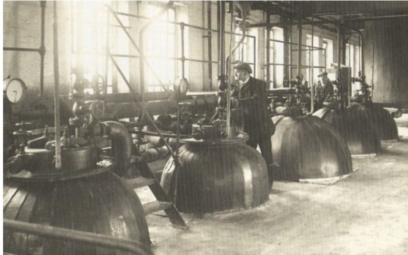
Abb. 170: Autoklavenspaltanlage in der Glycerinfabrik Geb. E 03
