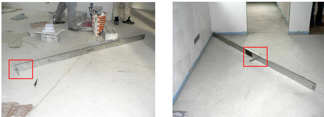
Abbildung 2.2.: Vertikale Verformungen (Schüsselung) bei schwimmenden Zementestrichen (sichtbarer Abstand unter der Richtplatte, siehe Markierungen in rot; Müller und Limp (2015))
