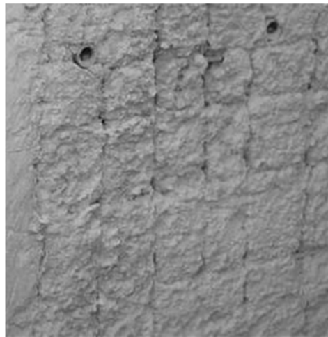
Bild 9 Foto einer Schlitzwand mit Matratzen-Effekt [3]
