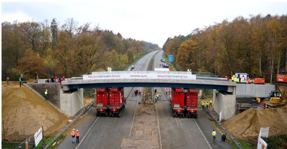
Abb. 4.5: Absetzen des vorgefertigten Brückendecks mit Hilfe von SPMT's auf die geogitterbewehrten Widerlager (Heitkamp Brückenbau)
