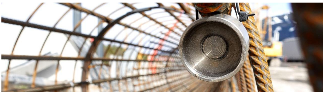
Abb. 2.1: Eingebauter Piezodruckaufnehmer mit Silikonverguss am Bewehrungskorb
