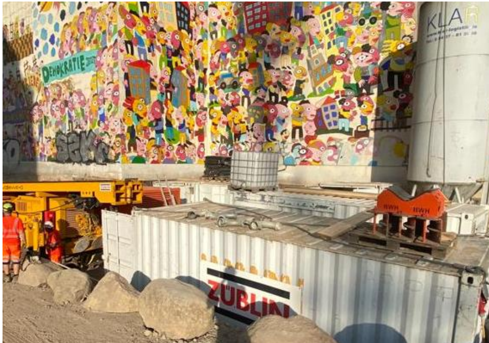
Abb. 2.6: Gelsohle: Anlagentechnik und Lanzenfeld (HOFFMANN 2022)
