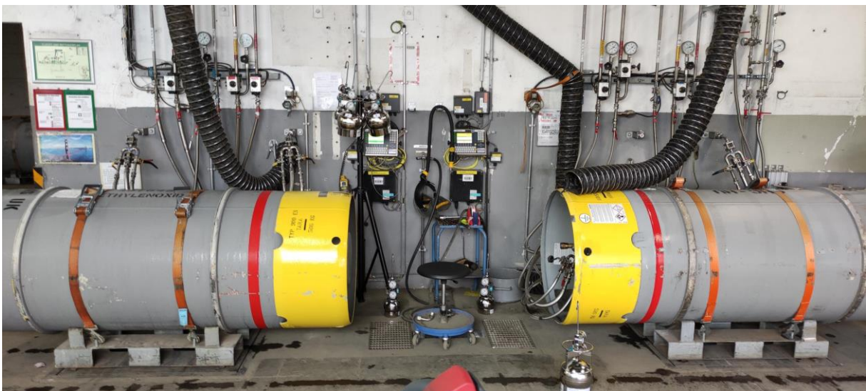
Abbildung 55: Tankbefüllungsstation ohne Umhausung mit handgeführter Absaugung und Ethylenoxid-Zufuhr
