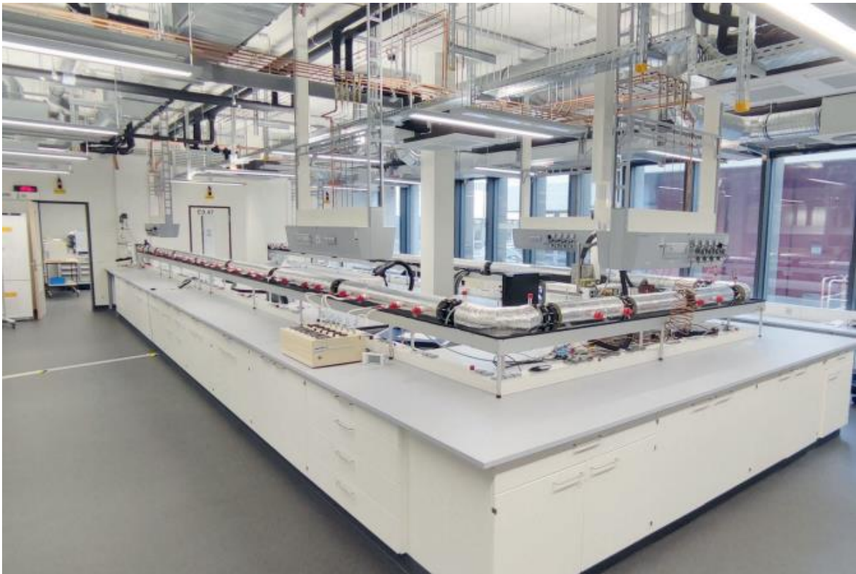
Abbildung 12: Übersicht der Prüfgasstrecke
