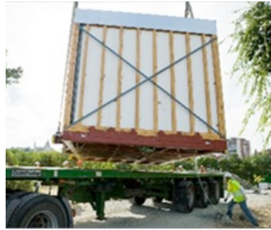
Foto 5.2.2.-2: Beispiel für vorgefertigte Module in der Größe kleinerer Räume. Das Foto zeigt das Haus des Teams SD EU 2012 AND während der Aufbauphase. Quelle: (Solar Decathlon Europe)
