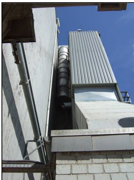
Bild D.16: Trockner mit Zuluftkanal und Abluftrohr [FSA,2010]
