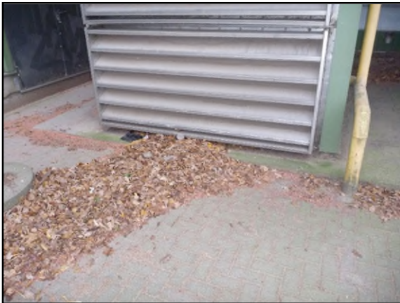
Bild 3.9: Ansaugbereich des Brenners
