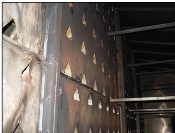
Bild A.12: Blick auf 3. und 4. Trocknungssäule
