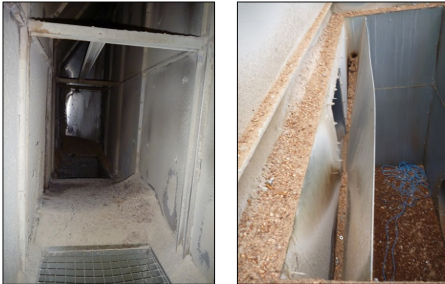
Bilder 3.13 und 3.14: Ablagerungen im Wärmerückführungskanal
