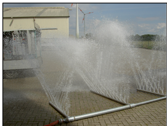
Bild 6.18: Löschwasserverteilung - vor Einbau in Trocknerkopf
