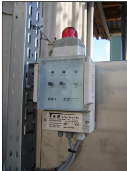
Bild 6.20: Im Abförderaggregat installierte Funken- / Glimmnestdetektion
