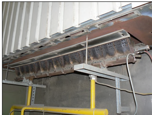
Bild 3.8: Rost im Bereich des Flächenbrenners
