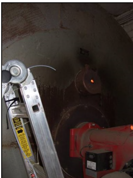
Bild D.22: Referenzluftabsaugung an der Brennkammer [FSA,2010]
