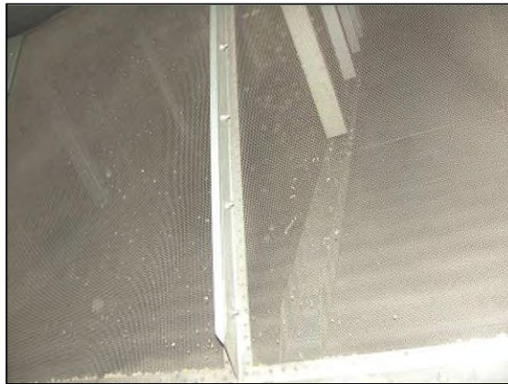
Bild 6.7: Im Zuluftschacht installierter Funkenfänger
