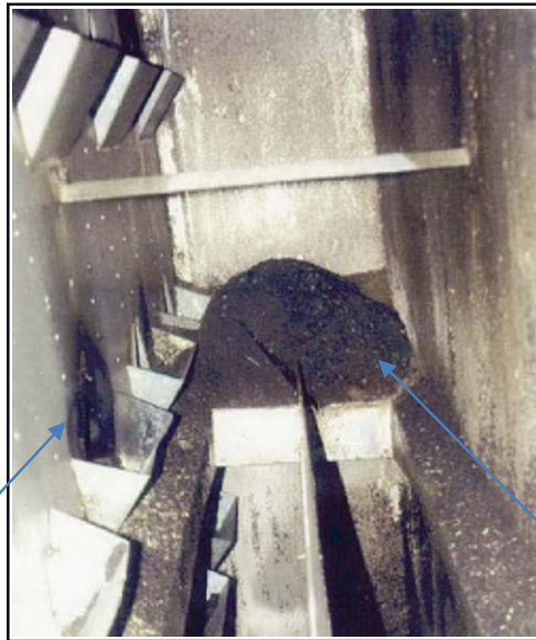
Bild A.4: Brandbeaufschlagung an den Ableitblechen sowie Rapskörner außerhalb Trocknungssäule [NACHTW,2005]
