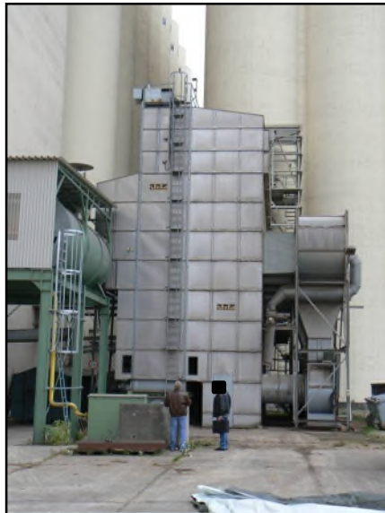
Bild A.5: Vom Schaden betroffener Trockner
