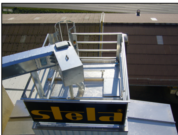
Bild 6.17: Löschwasserverteilung / Einbringung in Trocknungssäule
