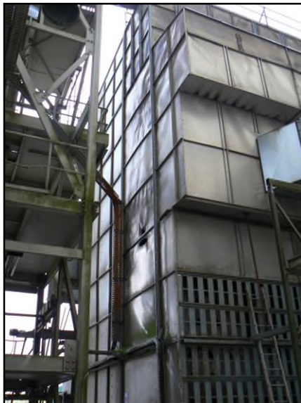
Bild A.10: Thermische Schäden an Außenhaut
