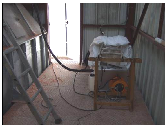
Bild D.29: Aufstellungsort Messgaskühler
