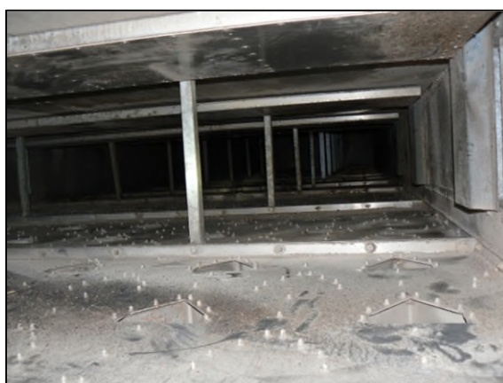
Bild 4.4: Fehlende Aufstiegshilfen im Zuluftschacht
