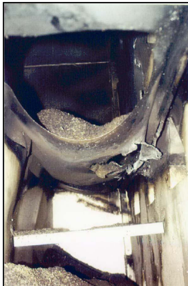
Bild A.3: Zerstörter Bereich zwischen Kühlzone (unten) und Wärmezone (oben) [NACHTW,2005]
