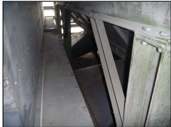
Bild 3.10: Ablagerungen im Ansaugbereich
